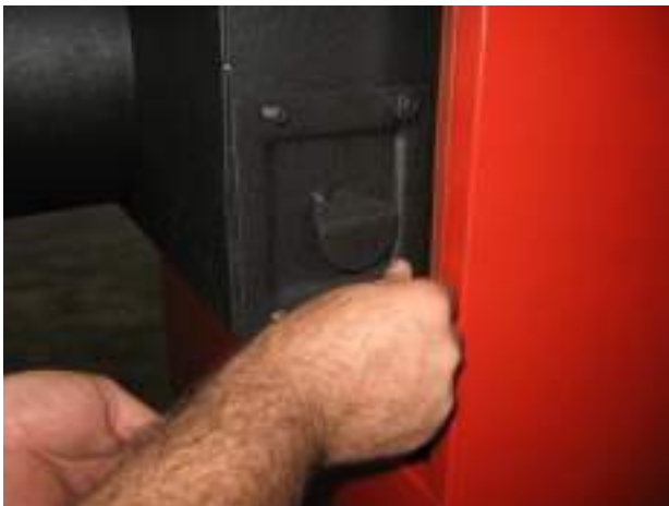
Рис. 9. Снятие заглушки для чистки адаптера дымохода.
