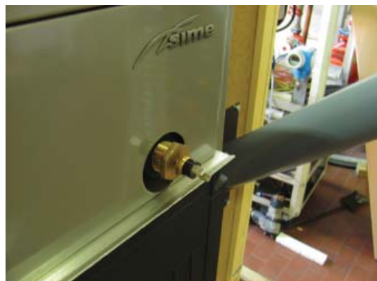
Εικ. 28 Θερμοστάτης ασφαλείας
